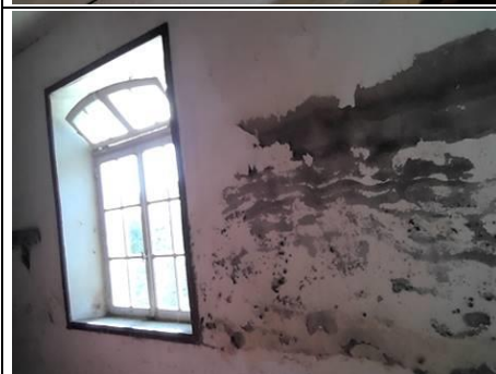
Photo n° PhTer006 Localisation : RDC - Réserve 1 Ouvrage : Mur Facade Avant, Embrassure de fenetre Parasite : Humidité Indices : Présence d'humidité (présence étendue)
