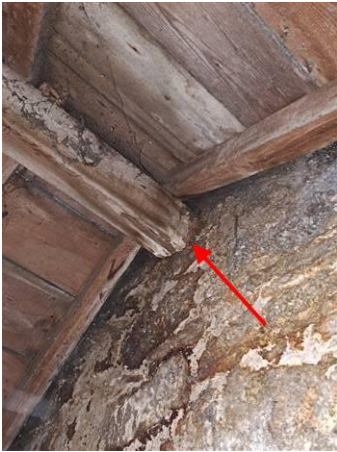
Photo n° PhTer020 Localisation : 2E - Combles 1 Ouvrage : Panne Fatière Parasite : Champignons de pourriture molle Indices : Présence de pourriture molle (présence sur une partie de l'élément)
