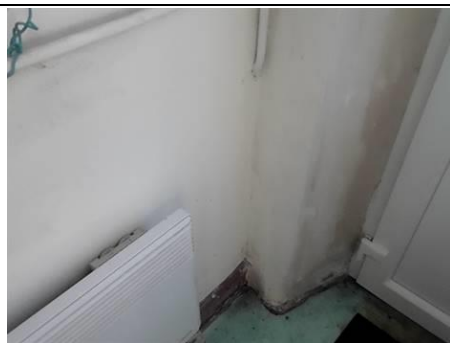
Photo n° PhTer001 Localisation : RDC - Entrée Ouvrage : Embrasure de porte Parasite : Humidité (remontées par capillarité) Indices : Présence d'humidité (Relevé hygrométrique supérieur à 50%)
