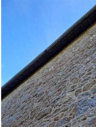
Photo n° PhTer015 Localisation : Parties extérieures Ouvrage : Facade Arrière Informations complémentaires : Gouttière dégradée
