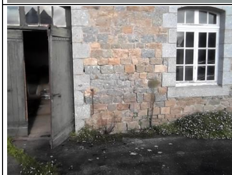
Photo n° PhTer011 Localisation : Parties extérieures Ouvrage : Pieds de murs périphériques Informations complémentaires : Jointure de maçonnerie dégradée
