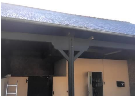
Photo n° PhTer014 Localisation : Annexe - Réserve 2 Informations complémentaires : Gouttières et ardoises Dégradées
