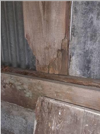
Photo n° PhTer017 Localisation : Annexe - Réserve 2 Ouvrage : Pieds de ferme Parasite : Champignons de pourriture molle Indices : Présence de pourriture molle (dégradation(s) importante(s))
