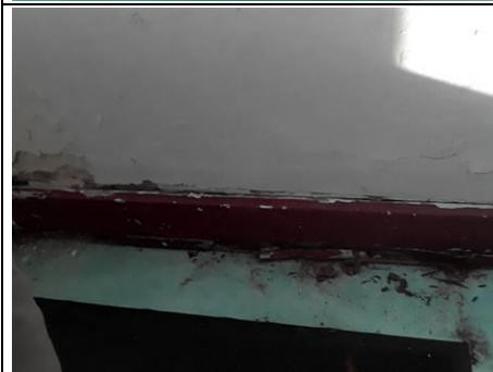
Photo n° PhTer003 Localisation : RDC - Entrée Ouvrage : Plinthes Parasite : Petites vrillettes (anobium), Champignons de pourriture molle Indices : Présence de trous de sortie, Présence de vermoulure (dégradation(s) importante(s)), Présence de pourriture molle (dégradation(s) importante(s))
