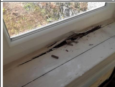
Photo n° PhTer005 Localisation : RDC - Local serveur Ouvrage : Tablette bois fenetre Parasite : Champignons de pourriture molle Indices : Présence de pourriture molle (dégradation(s) importante(s))
