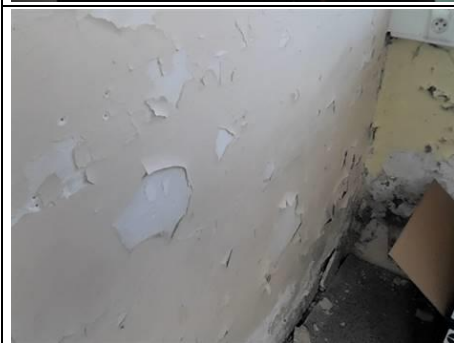
Photo n° PhTer004 Localisation : RDC - Local serveur Ouvrage : Pieds de murs périphériques et refend Parasite : Humidité (remontées par capillarité) Indices : Présence d'humidité (dégradation(s) importante(s))
