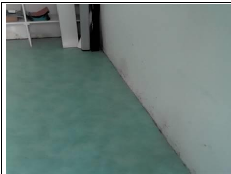
Photo n° PhTer002 Localisation : RDC - Entrée Ouvrage : Pieds de murs périphériques et mur de refend Parasite : Humidité (remontées par capillarité) Indices : Présence d'humidité (présence étendue)
