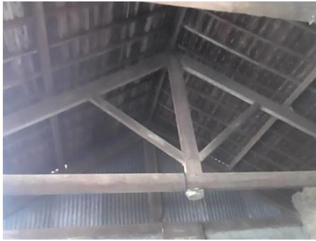
Photo n° PhTer012 Localisation : Annexe - Réserve 2 Ouvrage : Charpente bois Parasite : Petites vrillettes (anobium) Indices : Présence de trous de sortie, Présence de vermoulure (présence étendue)
