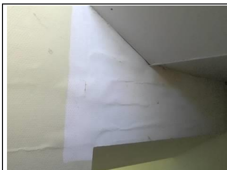
Photo n° PhTer007 Localisation : RDC/1ER - Cage d'escalier Ouvrage : Mur de refend Parasite : Humidité Indices : Traces d'humidité (Relevé hygrométrique inférieur à 20%)
