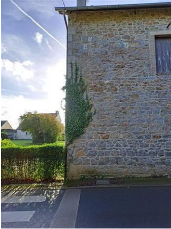
Photo n° PhTer016 Localisation : Parties extérieures Ouvrage : Mur Pignon et facade arrière Informations complémentaires : Présence de végétation invasive
