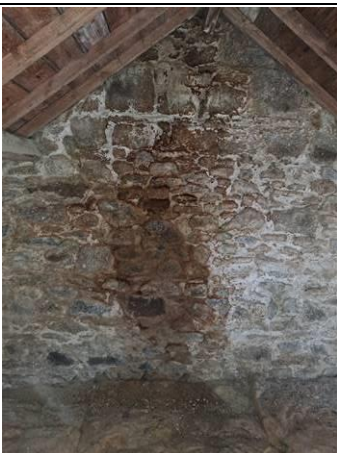
Photo n° PhTer019 Localisation : 2E - Combles 1 Ouvrage : Pur Pignon Parasite : Humidité (liée à une infiltration) Indices : Présence d'humidité (Relevé hygrométrique supérieur à 90%)
