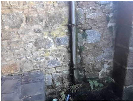
Photo n° PhTer013 Localisation : Annexe - Réserve 2 Informations complémentaires : Descente EP en charge et dégradé
