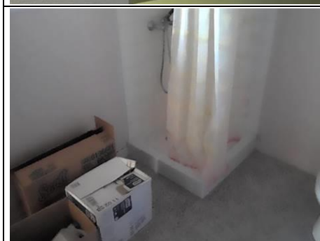
Photo n° PhTer008 Localisation : 1ER - SDE/WC 1; 1ER - SDE/WC 2 Ouvrage : Plancher bois Informations complémentaires : Réserve sur le principe d'étanchéité d'un appareil sanitaire posé ou fixé sur un plancher bois
