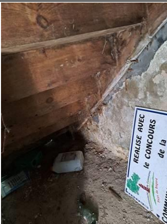
Photo n° PhTer018 Localisation : RDC - Entrée Ouvrage : Sous d'escalier Parasite : Humidité (remontées par capillarité), Petites vrillettes (anobium), Champignons de pourriture molle Indices : Présence d'humidité (présence étendue), Présence de trous de sortie, Présence de vermoulure (présence étendue), Présence de pourriture molle (présence étendue)
