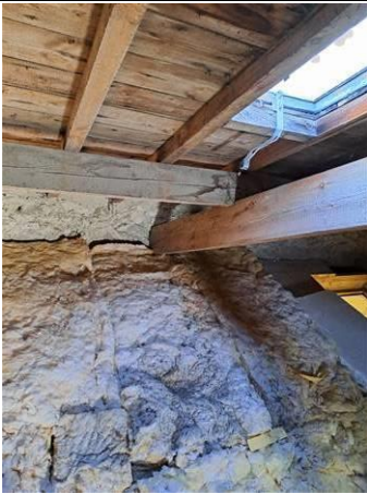
Photo n° PhTer021 Localisation : 1ER - Grenier; 2E - Combles 1; 2E - Combles 2 Ouvrage : Charpente bois Parasite : Petites vrillettes (anobium) Indices : Présence de trous de sortie, Présence de vermoulure (présence faible)
